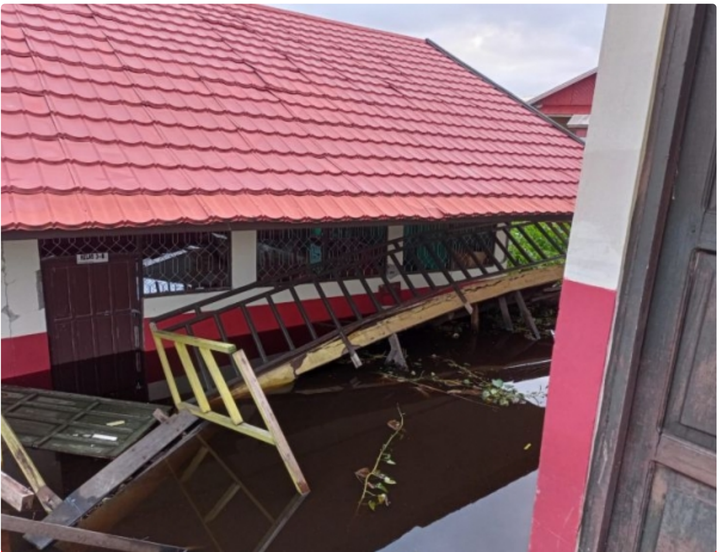
Bangunan SDN 14 Palangka Raya yang ambruk
